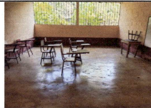
Foto 6: Piso de torta de cemento en mal estado, en las aulas.
