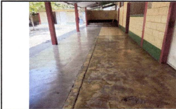
Foto 1: Piso de torta de cemento en mal estado, en el corredor
