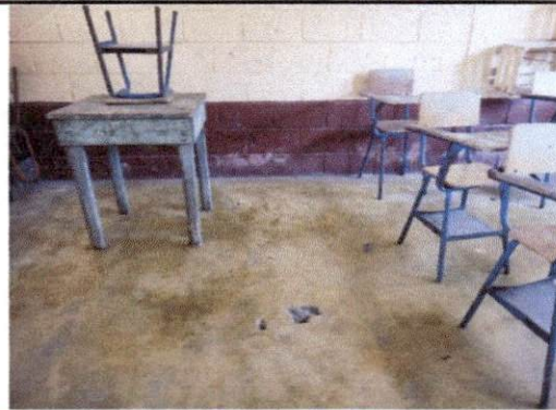
Foto 4: Piso de torta de cemento en mal estado, en las aulas.
