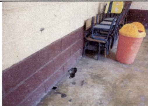
Foto 5: Piso de torta de cemento en mal estado, en las aulas.
