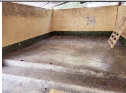
Foto 2: Piso de torta de cemento en mal estado, en el escenario
